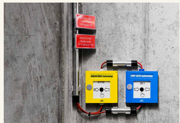
Gaslöschanlage im Fernheizwerk Arsenal
