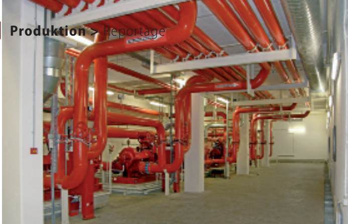
Bildquelle: Hoyer Brandschutz
