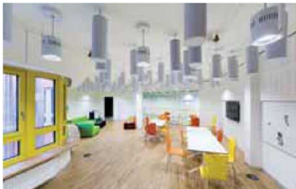
Department Verwaltung Aufenthaltsraum: Aufgrund der Akustikbaffeln wurde u.a. dieser Raum mit Steuersprinklern mit offenen Löschdüsen geschützt; die Löschdüsen werden über Strangrohre mit Löschwasser versorgt. Foto: Robert Tober
