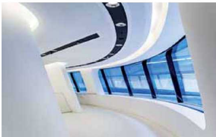
LLC Unsichtbarer Brandschutz: Schwarz lackierte Sprinklerköpfe machen die Brandschutzanlagen im futuristischen Raumdesign nahezu unsichtbar. Foto: Robert Tober
