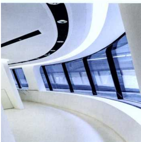
LLC Unsichtbarer Brandschutz: Schwarz lackierte Sprinklerköpfe machen die Brandschutzanlagen im futuristischen Raumdesign nahezu unsichtbar.
