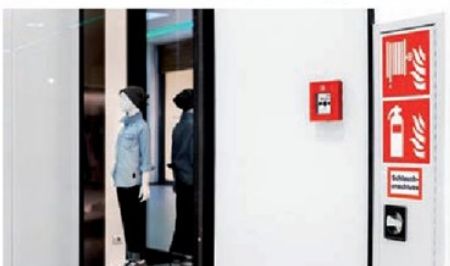
Oben: Manuelles Bedienfeld der Rauch- und Wärmeabzugsanlage für die Feuerwehr. Unten: Handauslösetaster zur Alarmierung der Feuerwehr.
