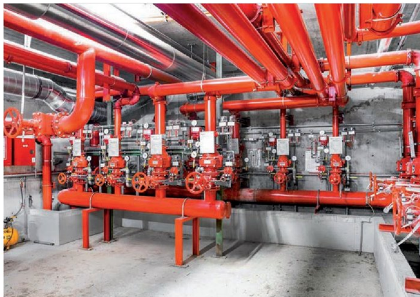
Die neue Sprinklerzentrale im Shoppingcenter Auhof
