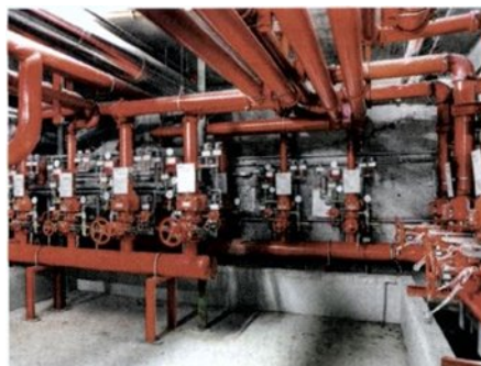
Sprinklerzentrale im Auhof Center, dem zweitgrößten EKZ der Bundeshauptstadt
