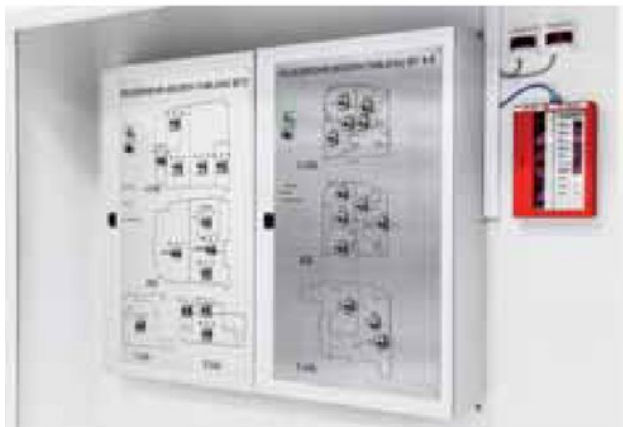
Manuelles Bedienfeld der Rauch- und Wärmeabzugsanlage für die Feuerwehr.
