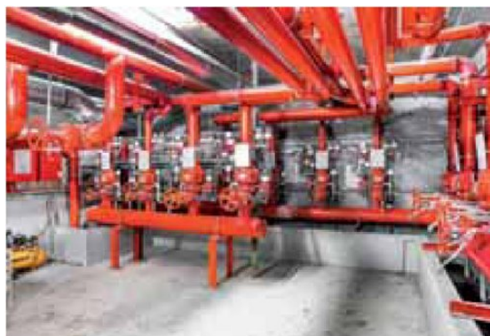
Blick in die Sprinklerzentrale. Alle Fotos: Robert Tober für Hoyer Brandschutz.
