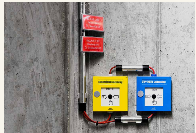
Handauslösung und Stopp-Taster der Gaslöschanlage im Fernheizwerk Arsenal
