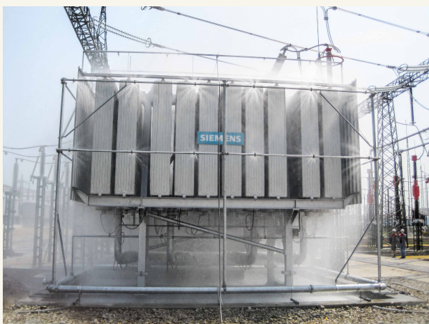
Sprühflutkäfig für einen Transformator des Umspannwerks Bisamberg
